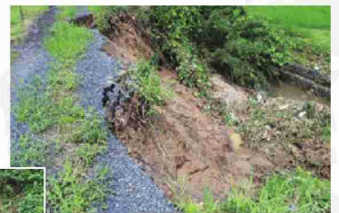
↑土砂崩れで通行できなくなった道路(7月20日 古川北宮沢)
