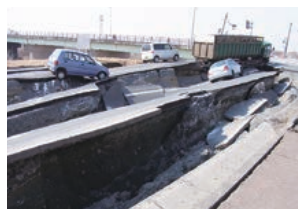
深い亀裂が入った路面 (富永地区)
